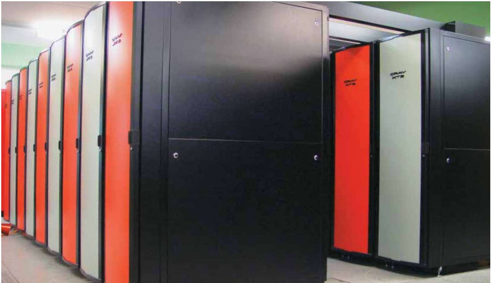
Einer der leistungsstärksten Rechner Europas steht im Hochleistungsrechenzentrum CSCS in Manno.
